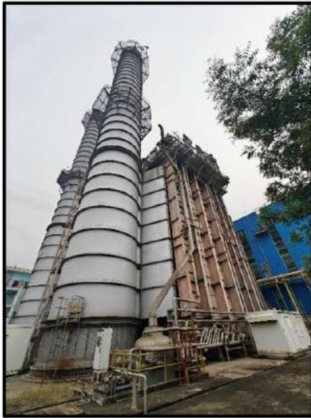
HRSG – 11 Left View
