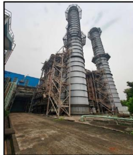
HRSG -12 Right View
