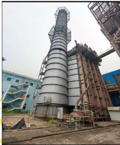
HRSG -12 Left View
