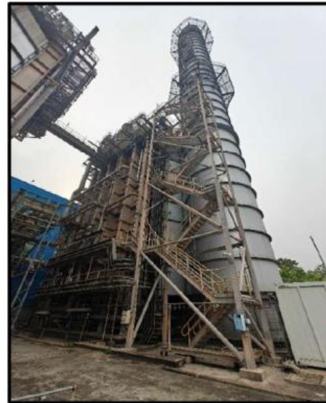
HRSG – 11 Right view
